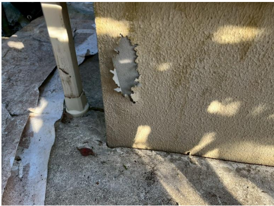
● 基礎 塗膜のハガレ部分
