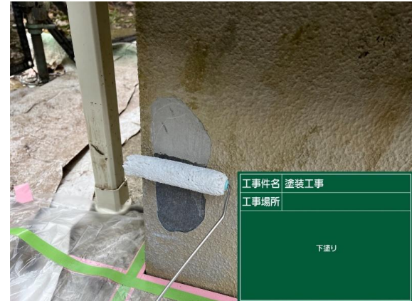
● 基礎 塗膜のハガレ部分 下塗り エポキシ樹脂シーラー
