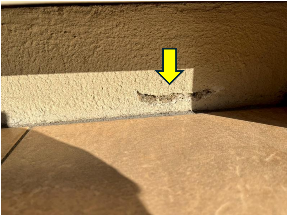
● 基礎 モルタル欠損部
