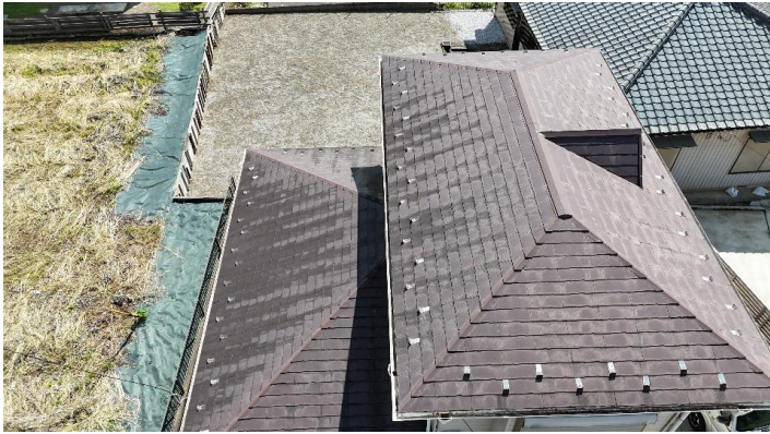
● 屋根全体写真 退色や苔の発生が見られますが、基材の浮きやズレ、損傷はありません。
