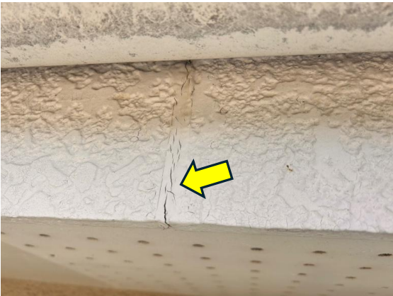
● 破風板 塗膜の退色があります。 継ぎ目 目地のシールが劣化して切れています
