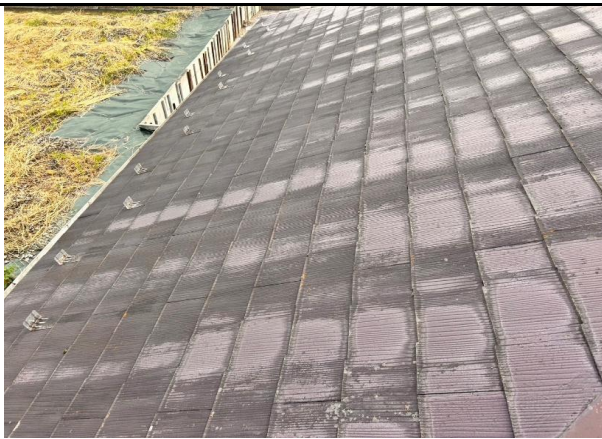
● 1階北側屋根 退色が進んでいて、防水性が低下しています。
