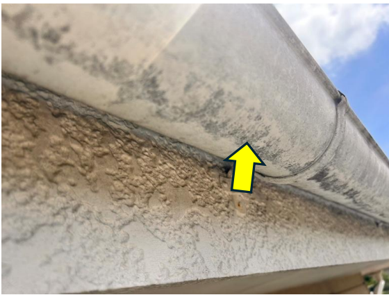
● 雨樋 (軒樋) 汚れがあります
