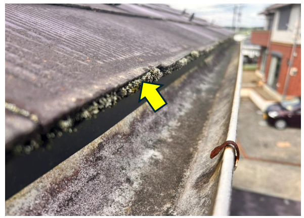
● 2階屋根 鼻先 苔の蓄積があります。
