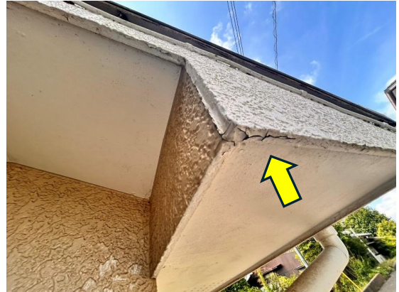
● 破風板 塗膜の割れとハガレがあります
